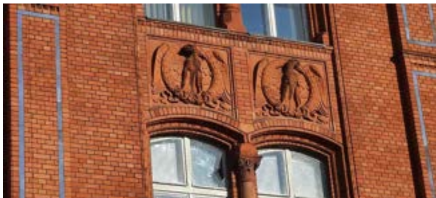
Orły na ścianie Poczty od strony zachodniej przy placu Tobruckim
